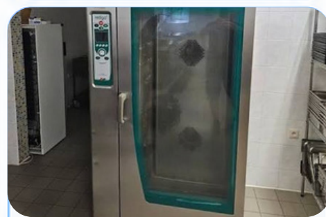
ŠKOLNÍ KUCHYNĚ S NOVÝM KONVEKTOMATEM
